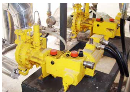
▲ 石化：催化剂注入泵
